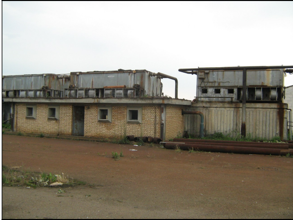
Pumpna stanica sa rashladnim kulama
